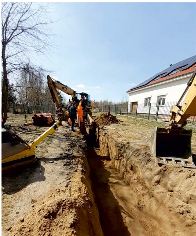
KIEKRZ ul. SARNIA WFOŚiGW POZNAŃ
