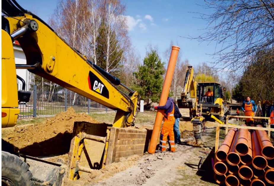
KIEKRZ ul. SARNIA WFOŚiGW POZNAŃ
