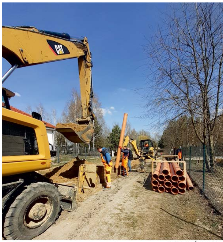
KIEKRZ ul. SARNIA WFOŚiGW POZNAŃ
