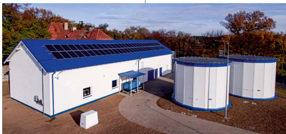
Stacja Uzdatniania Wody Mrowino - październik 2020
