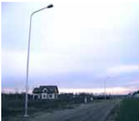
Sobota-Bytkowo – rozdzielnia ZKP oraz lampy uliczne przy ul. Porzeczkowej w Bytkowie
